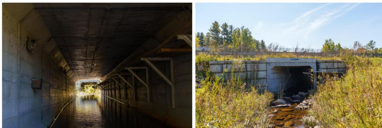
Figure 5. Ponceaux aménagés pour la faune près de la sortie 115 à Magog, à la suite des travaux réalisés en 2020 (© Charles Dion)
